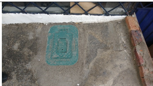
Foto No. 4 Registro de acueducto, instalado el año pasado
